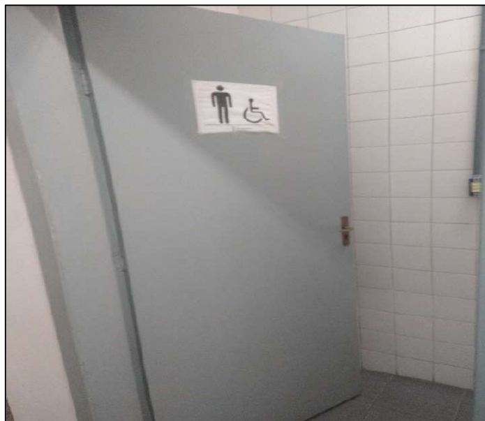
Figura 13 - Porta banheiro acessível pavilhão 2
