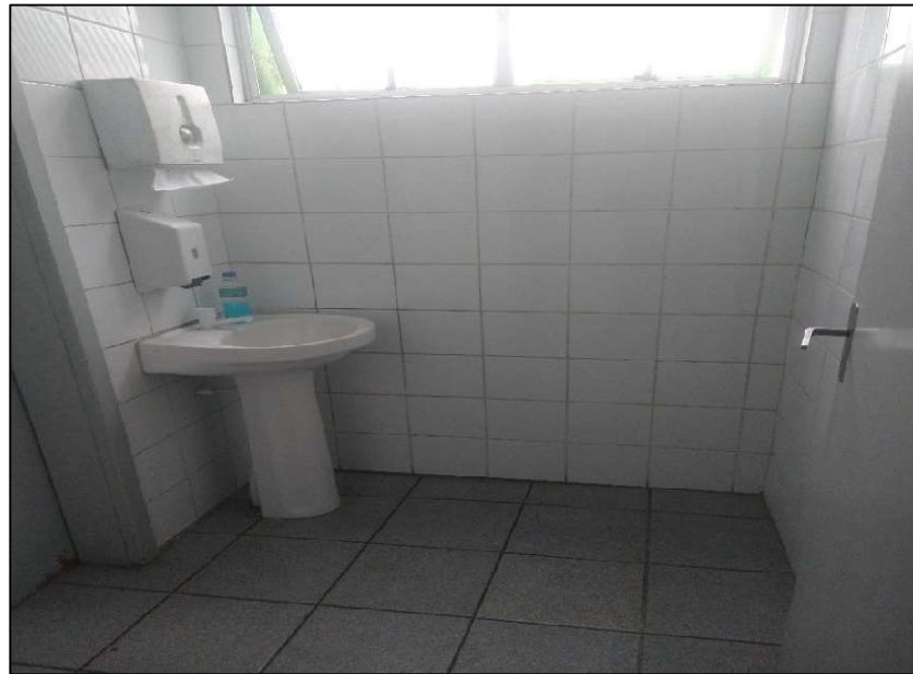
Figura 17 - Pia banheiro alunos do curso de geoprocessamento
