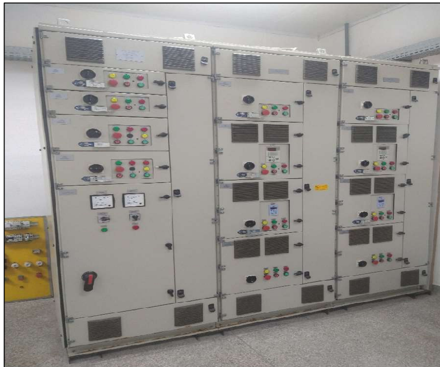
Figura 46 - Centro de controle de motores de baixa tensão
