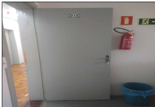
Figura 32 - Porta de entrada do laboratório de controle lógicos e programáveis
