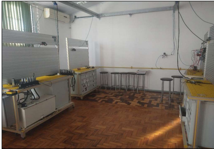
Figura 31 - Espaço entre bancadas laboratório de hidráulica e pneumática
